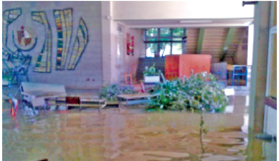
Wasser flutete das Schulhaus und richtete grosse Zerstörung an.
