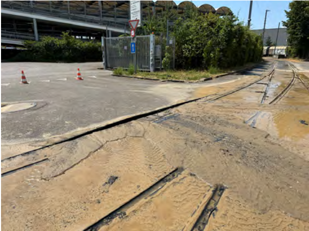
Wasserleitungsbruch Bresteneeggstrasse 1. Juli 2025
